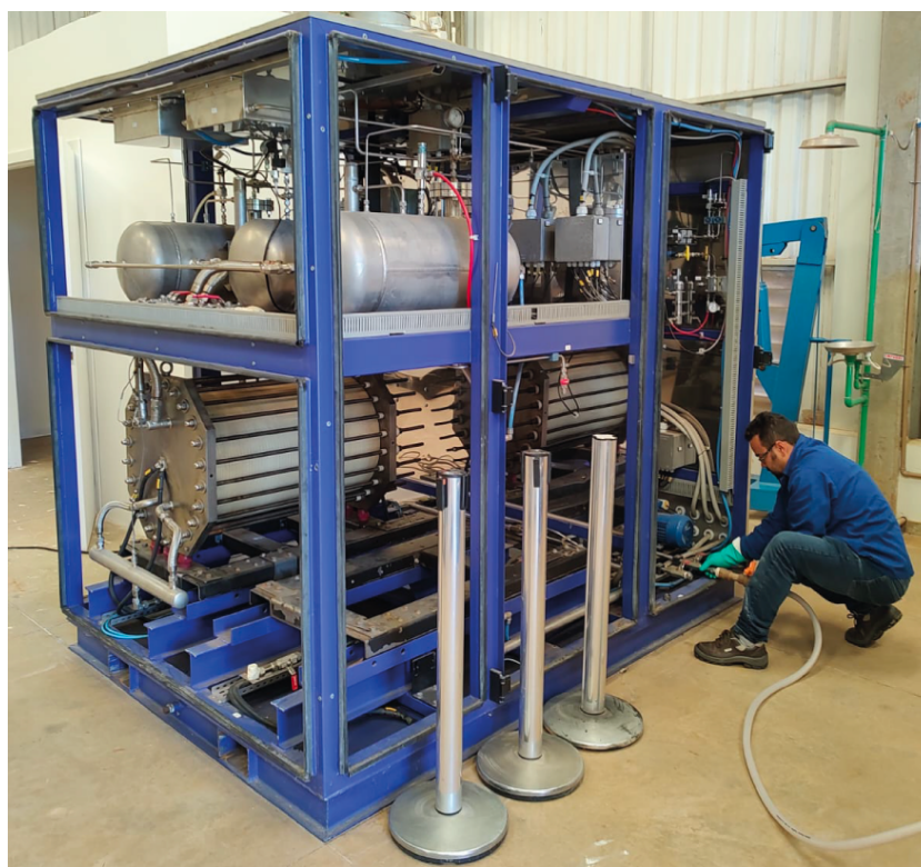
Figura 6- Planta Piloto de Hidrogênio na UHE Itaipu Binacional.
