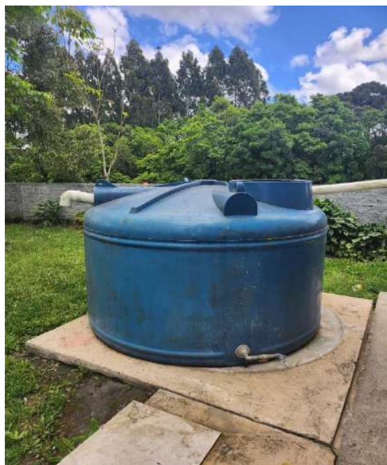
Figura 2: Caixa d'água da captação da chuva
